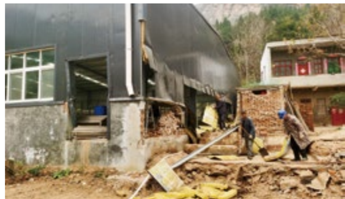
被水灾损毁的豆腐坊
